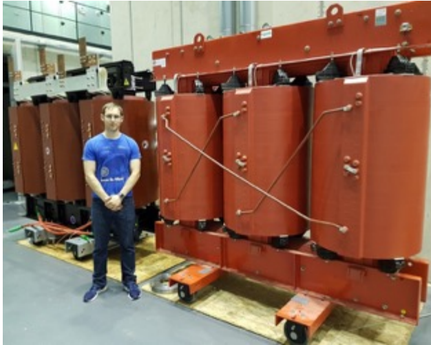
4,5 MVA, 50 Hz Transformer 11.500 kg (2,5 kg/kVA)
